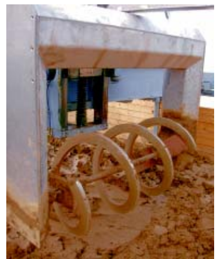
Keine neue Stelle im Dienstpostenplan! Der Klärschlammmanager ist eine technische Einrichtung zur Manipulierung des Klärschlammes in der solaren Trocknungshalle
